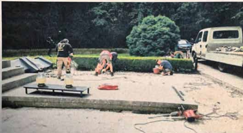
W ubiegłym tygodniu rozpoczęto prace przy wymianie płyt we frontowej części pomnika.
